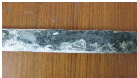
Слика 2. Цев еко-пакета вреловодног котловског постројења са површинским депозитом
