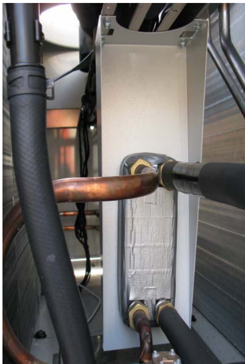
Слика 6. Плочасти размењивач топлоте за припрему санитарне топле воде
