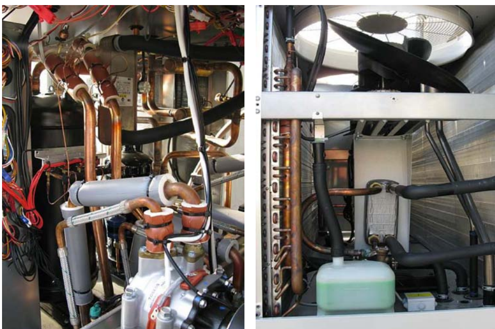
Слика 9. Део кондензаторског агрегата гасне топлотне пумпе
